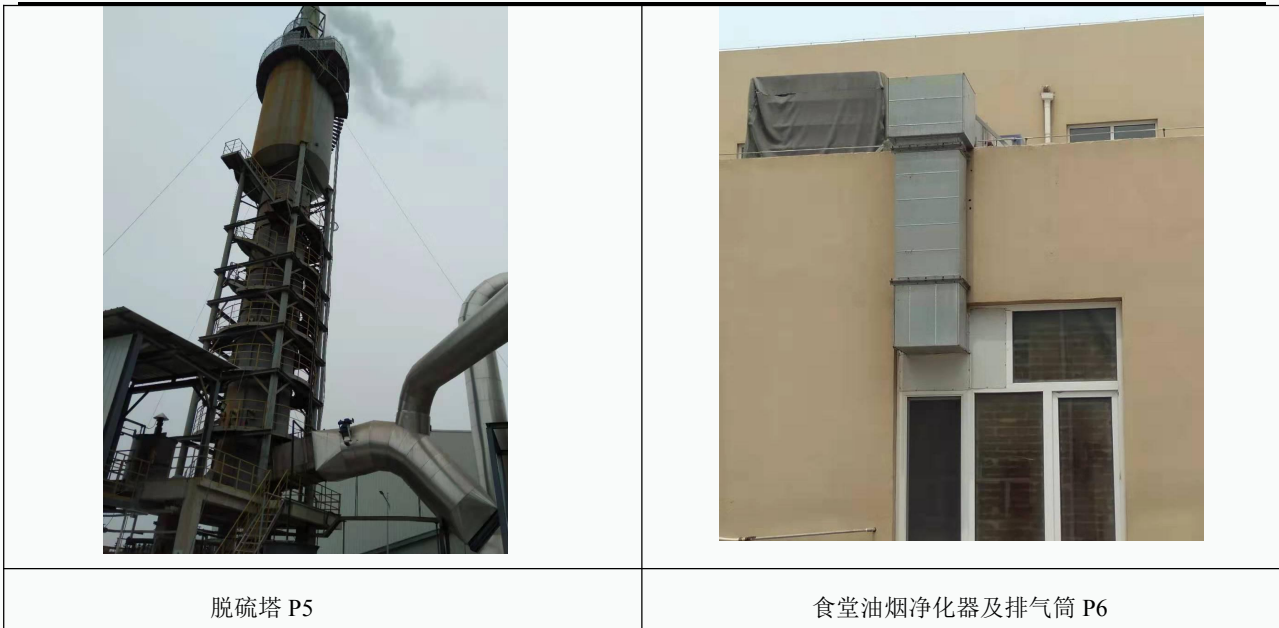
图 5 项目废气收集、处理设施图片
