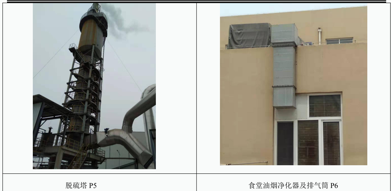
图 5 项目废气收集、处理设施图片
