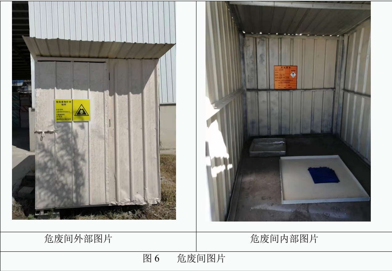
项目危废间的建设情况图片
