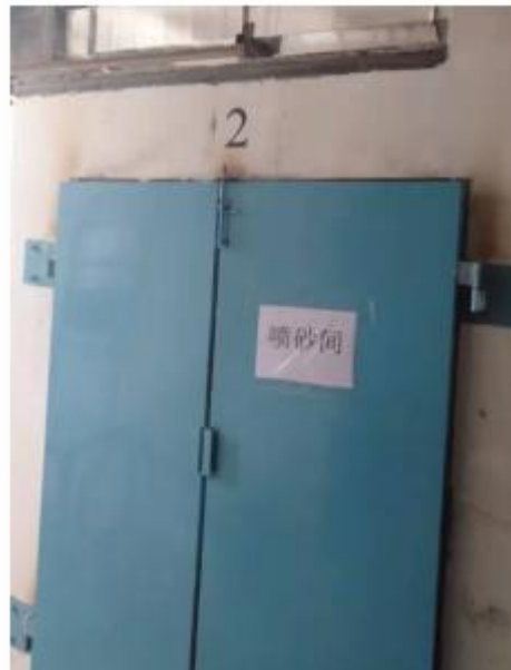
项目喷砂室、喷涂室图片
