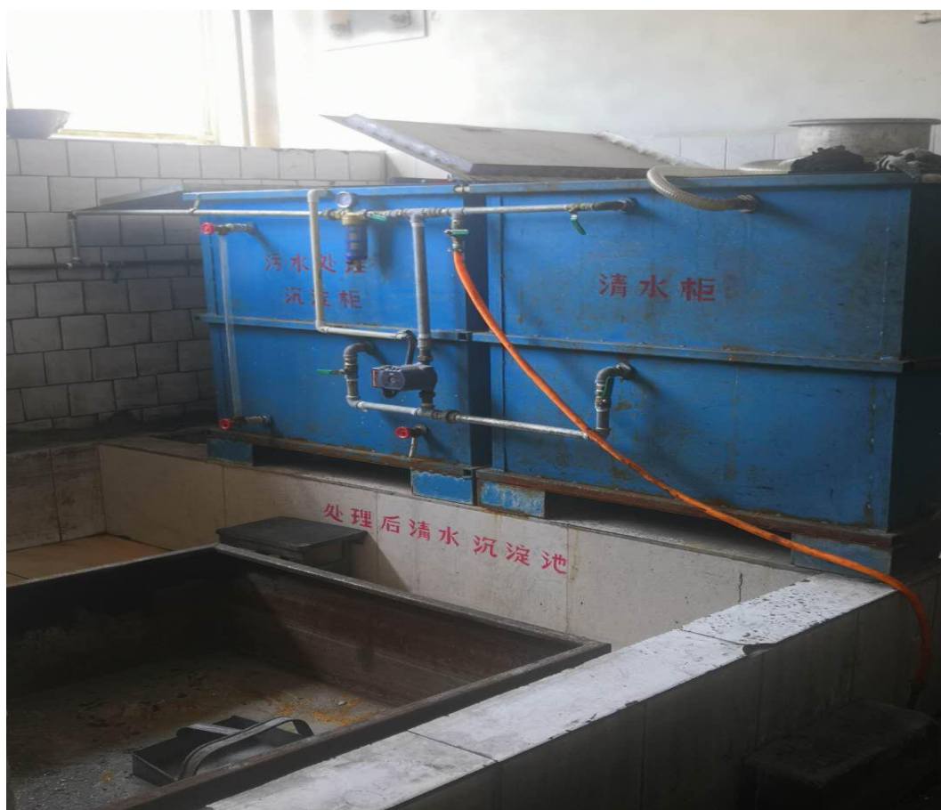
污水处理设备
