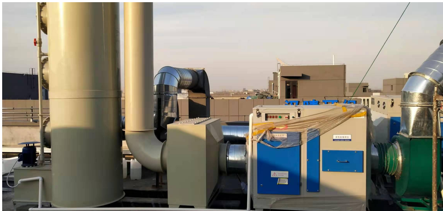
水喷淋+除雾器+活性炭吸附装置
