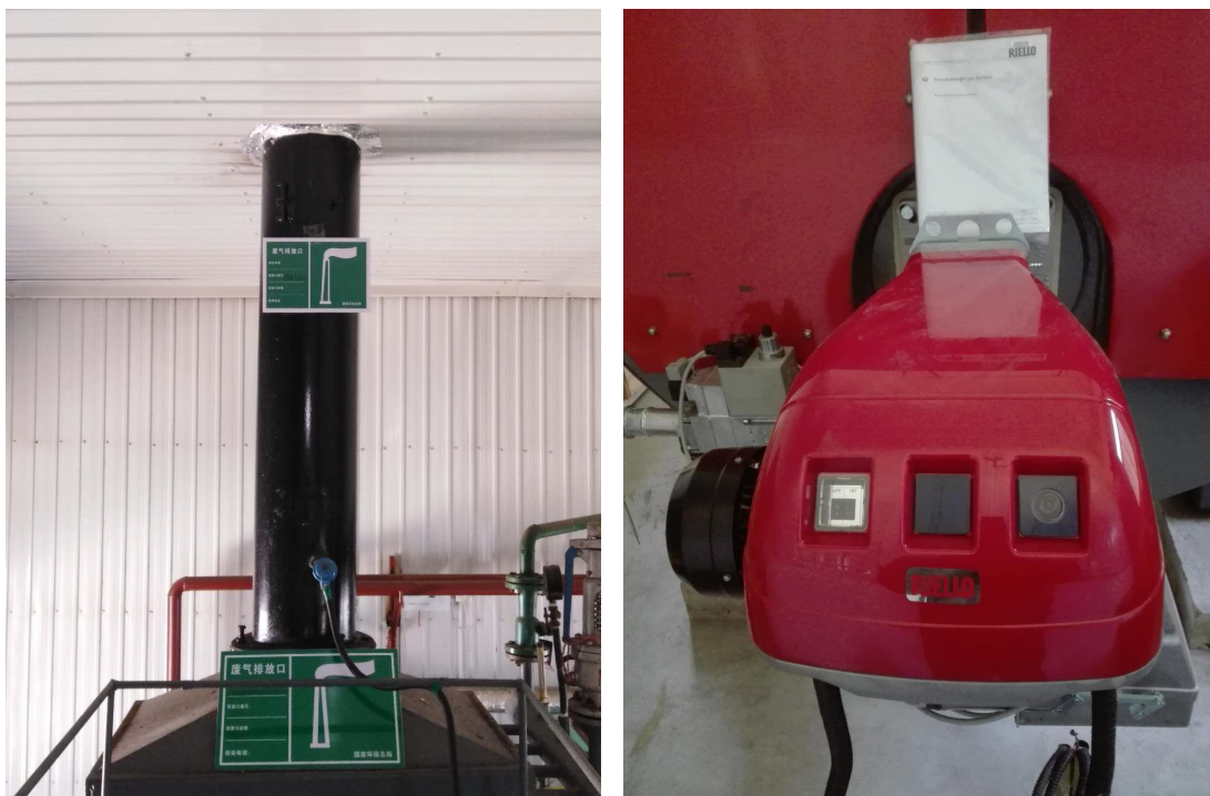
图 2.4-1 现有工程锅炉排气筒 DA001 及低氮燃烧器图
