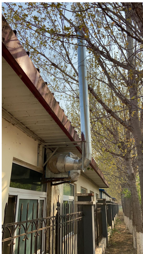
图 2.4-2 现有工程油烟排气筒 DA002 及油烟净化器图
