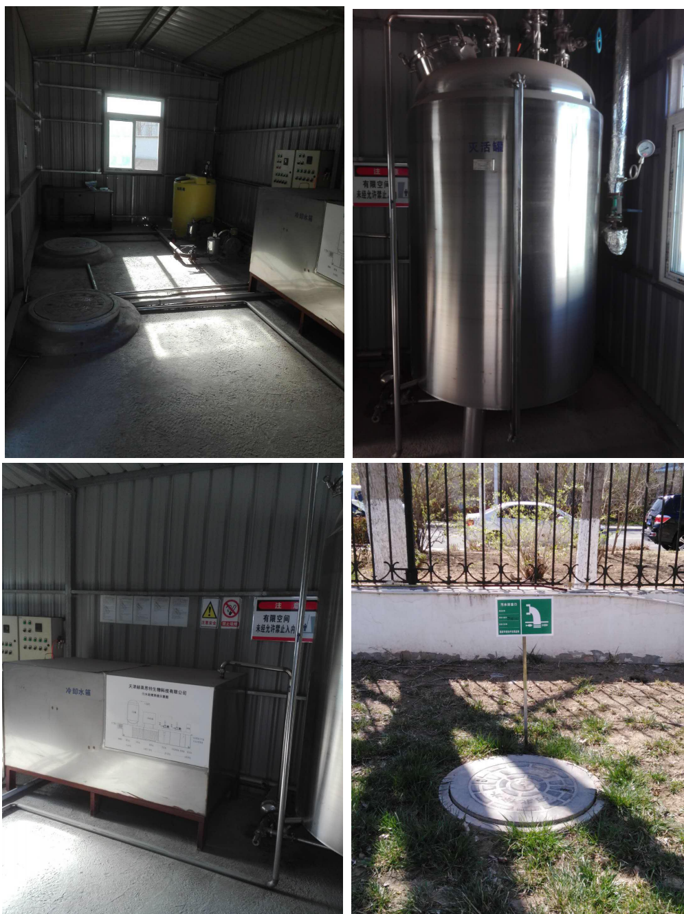
图 2.4-4 现有工程污水处理设施及污水排放口图
