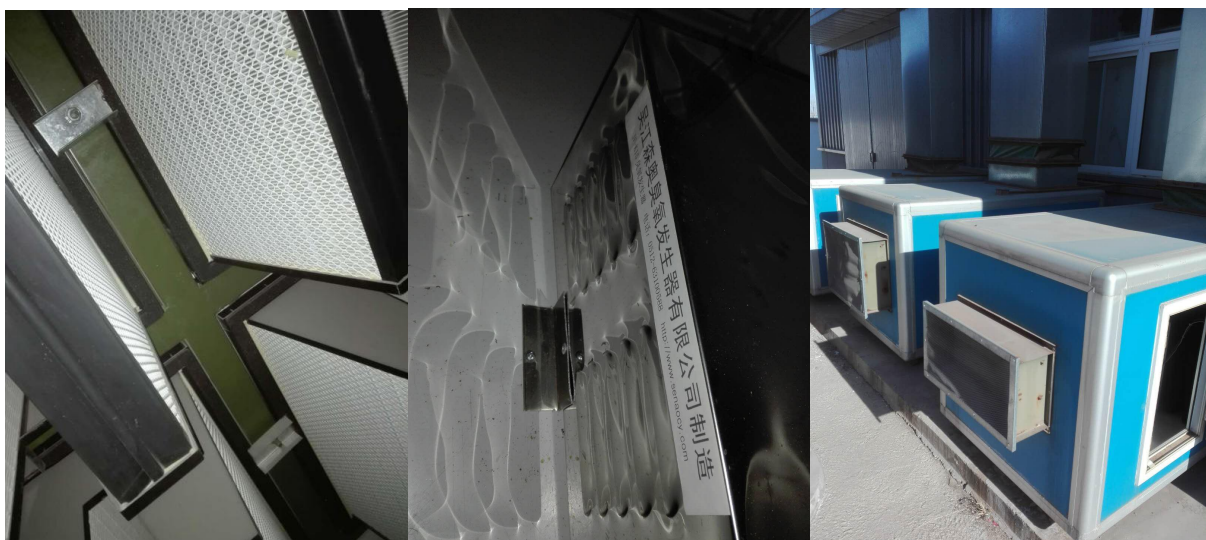
图 2.4-3 现有工程高效空气过滤器、臭氧发生器及活性炭装置图
